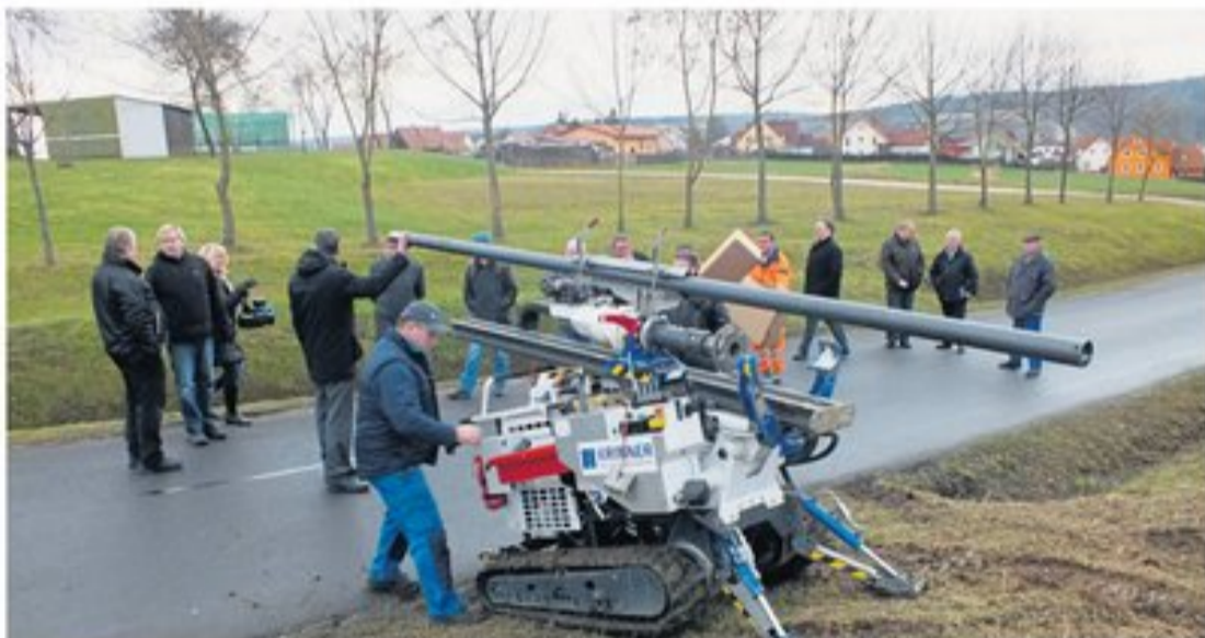
Diese Spezialmaschine schraubt die Schraubfundamente ein und platziert auch gleich noch die Solarlampe darin. Bilder: Harald Mohr
